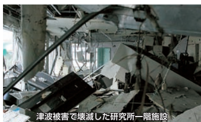
津波被害で壊滅した研究所一階施設
