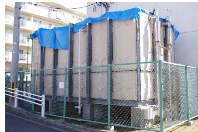
仙台市内のFRPタンクの被害
